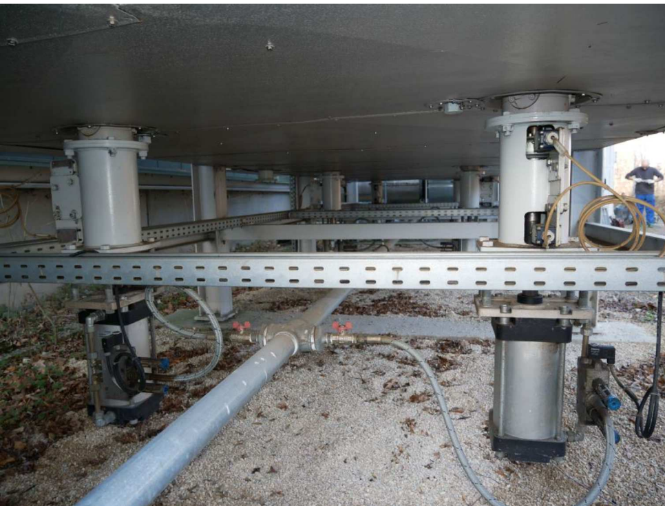
Pneumatikantriebe der Hubklappen
