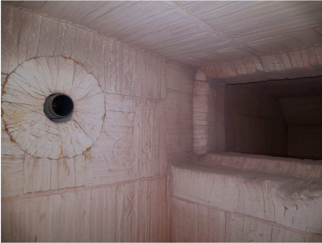
Brennkammerinnenauskleidung mit Brennerrohr
